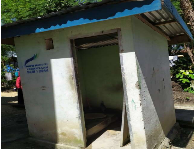
Gambar 1. Kamar mandi umum yang tidak berfungsi
