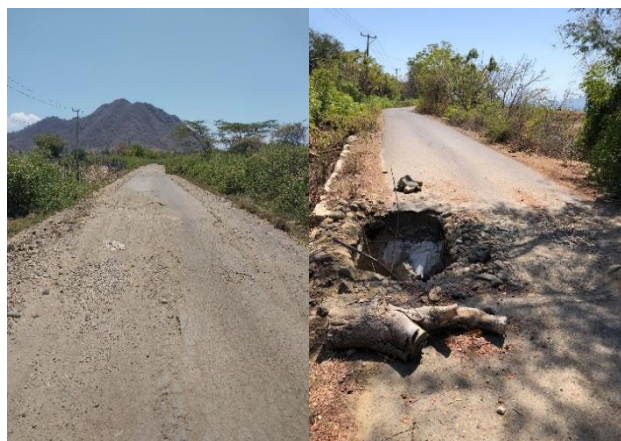
Gambar 5. Kondisi Infrastruktur Jalan Menuju Desa Labuhan Sangoro.
